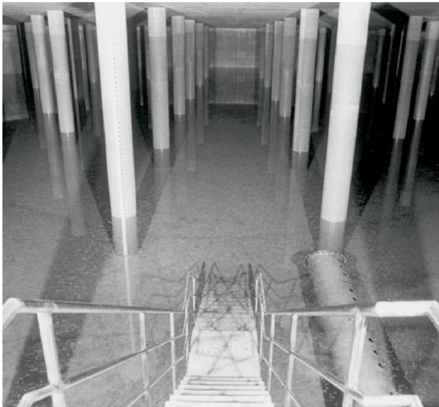
Wasserreservoir auf dem Oberfeld, errichtet 1985-1988, Aufnahme August 1990
